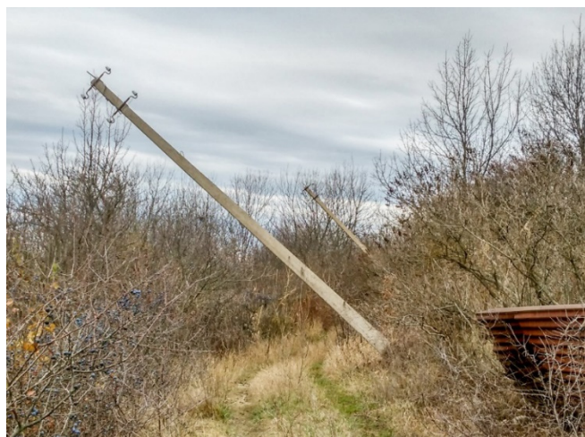
Рис. 4. Крен столбов линии электропередач в СНТ "Электрик"
