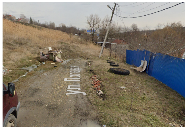
Рис. 3. Мамайский оползневой район. Деформации проезжей части и столбов на ул. Полевой и жилых домов под языком оползня
